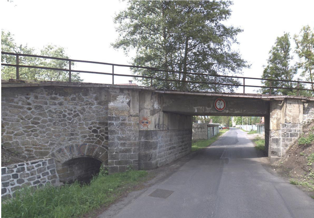
Obrázek 23 Nedostatečně vysoký podjezd v Březové ulici (zdroj: mapy.cz)
