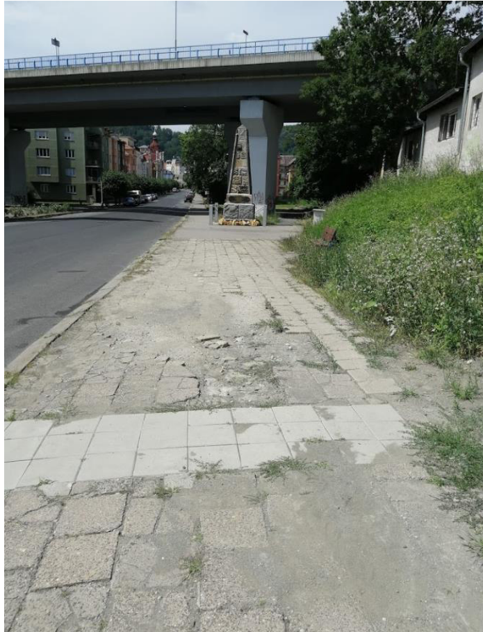
Obrázek 28 Stav chodníku na ul. 17. listopadu (zdroj: RHDHV)
